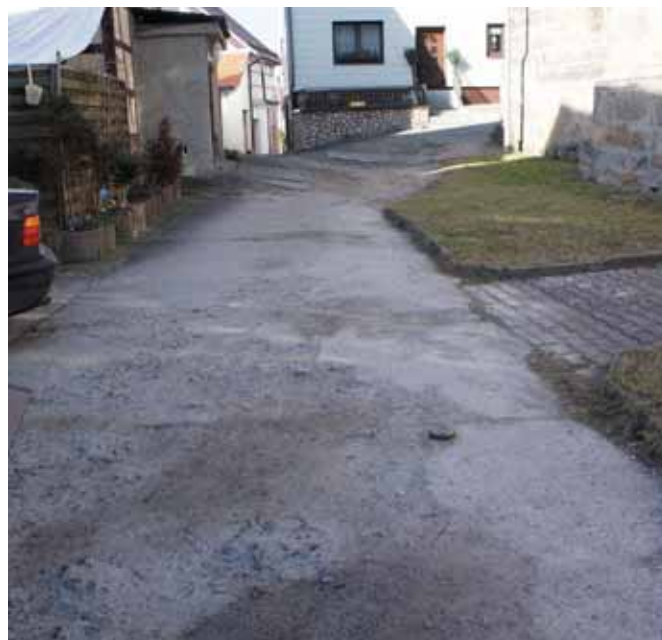
Abb.111.: Straßenzustand Kirchgasse Teichröda, Quelle: eigene Aufnahme
