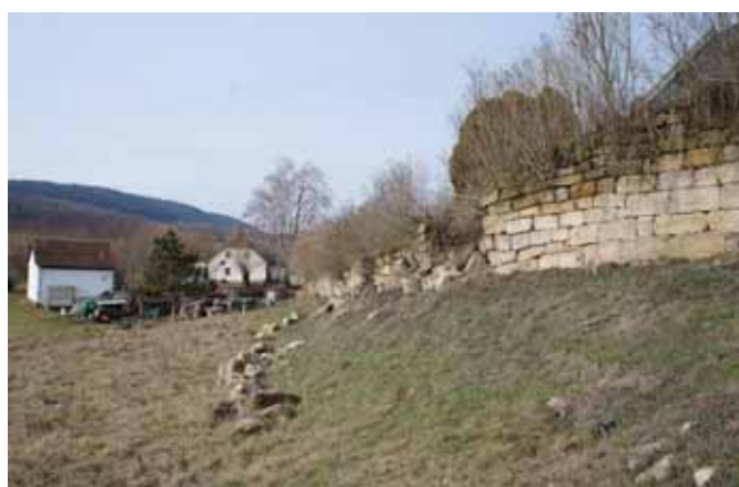
Abb.112.: Sanierungsbedürftige Kirchmauer, Quelle: eigene Aufnahme
