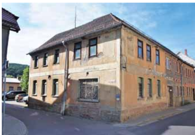
Abb.114.: Schrottimmoblie in Remda, Quelle: eigene Aufnahme
