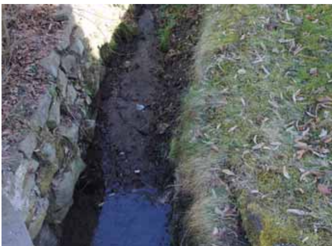
Abb.123.: Derzeitiger Zustand Bacheinfassung am Dorfge- meinschaftshaus Geitersdorf, Quelle: eigene Aufnahme
