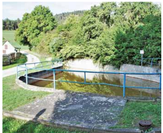
Abb.98.: Sanierungsbedürftiger Feuerlöschteich in Milbitz, Quelle: eigene Aufnahme
