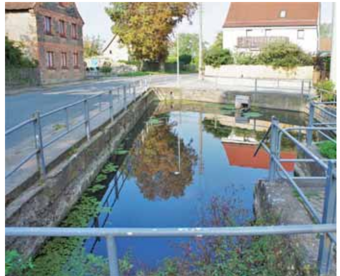
Abb.97.: Sanierungsbedürftiger Feuerlöschteich in Haufeld, Quelle: eigene Aufnahme
